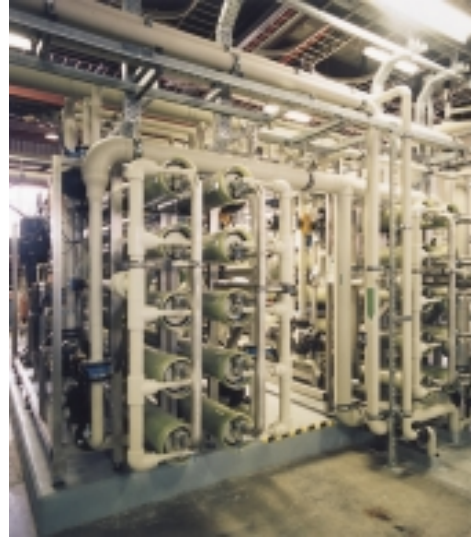
Die Hyperfiltrationsanlage ist die letzte Stufe der neuen Recyclinganlage, mit der 530 000 m 3 Trinkwasser pro Jahr eingespart werden sollen
