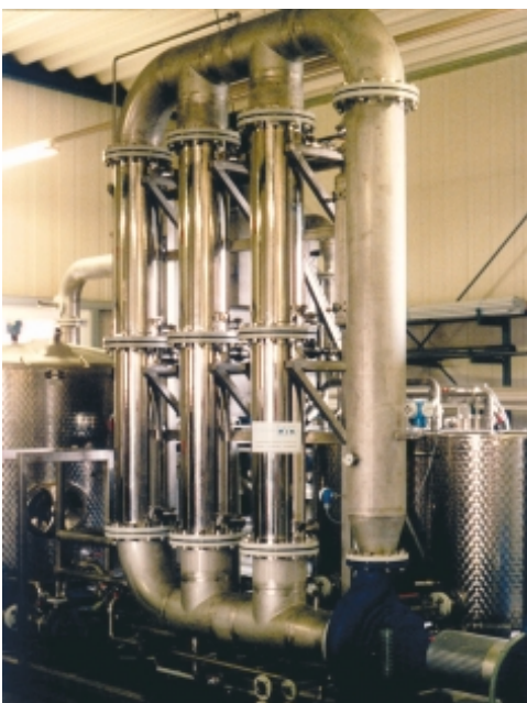
4: Zweistraßig ausgeführte Ultrafiltrationsanlage mit je 56,4 m 2 Filterfläche
